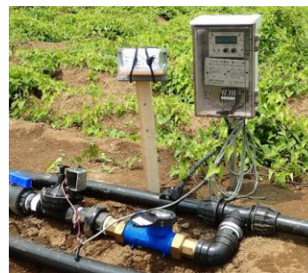
かん水制御装置
